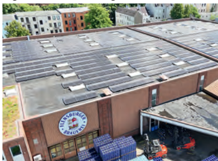
Teil der Photovoltaikanlage auf dem Dach der Flensburger Brauerei.
